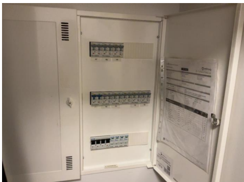
Sikringsskap plassert i skap i entré
